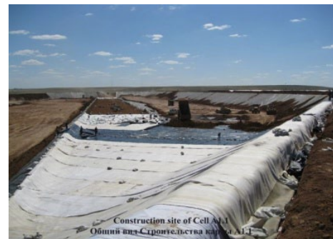
Строительство участка для захоронения ртути содержащих отходов в рамках проекта Всемирного банка
